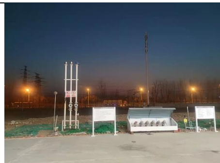
卸油口及卸油油气回收装置
